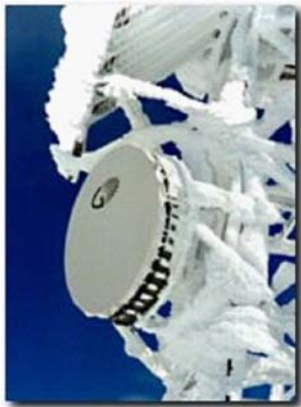
Figura 4: La utilización de radomos de protección evita la acumulación de hielo y nieve en las antenas.
